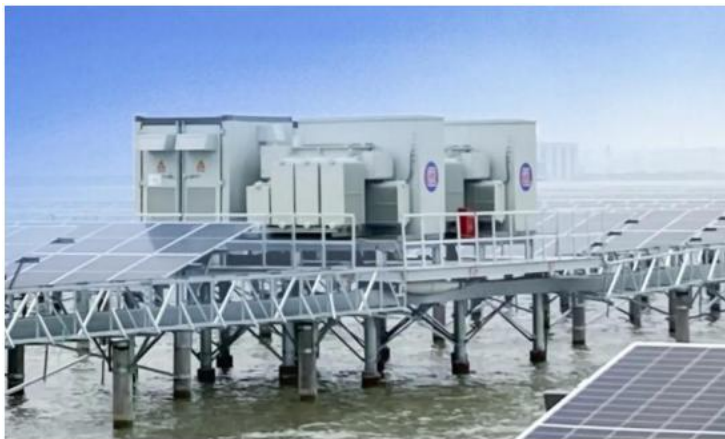
正泰温州泰瀚 550MW 海洋光伏电站
